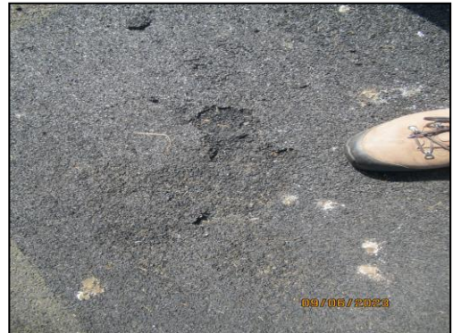
(Damaged wet pour)
